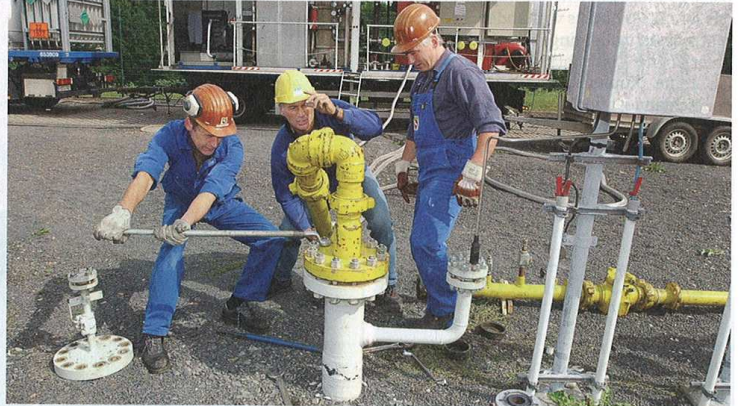
Ein mühsames Geschäft haben nicht nur die Arbeiter beim Verlegen von Gasleitungen, sondern auch diejenigen, die mit Konzernen um Netzübergaben kämpfen. Bild: Wings
